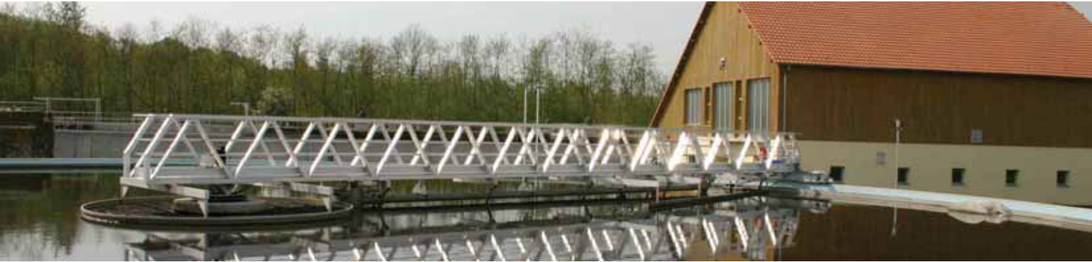
Station d'épuration : clarificateur nouvelle file.
